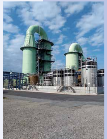
ブローアウト法によるヨウ素生産設備
